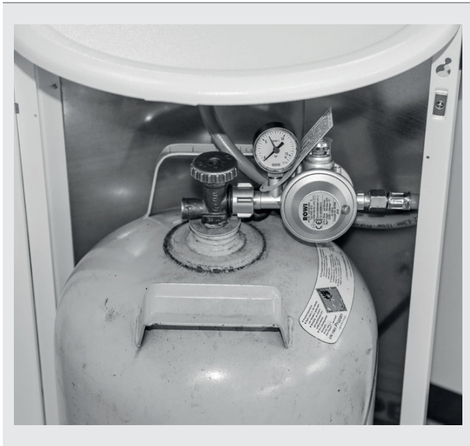
Abb.3: Installation der Gasflasche
